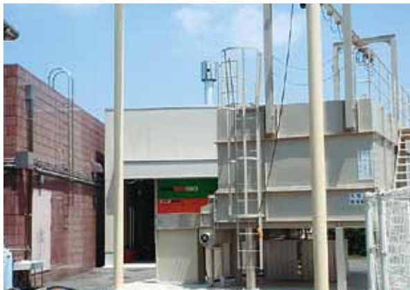
福岡県内温浴施設に導入されている木質バイオマスボイラー施設 (中央奥がボイラー本体、右側が燃料サイロ)
