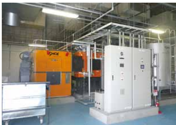
木質バイオマスボイラー
