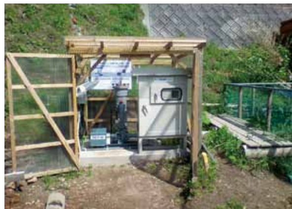
小水力発電機器
