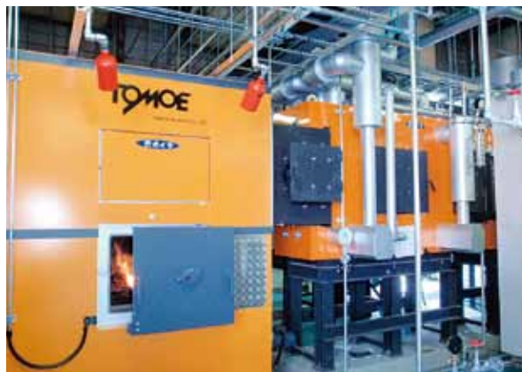
病院地区エネルギーセンターに導入された木質チップ蒸気ボイラー設備
