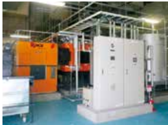
木質ボイラー
