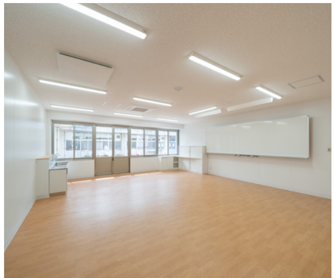
▲ 全熱交換器、LED 照明を採用した教室
