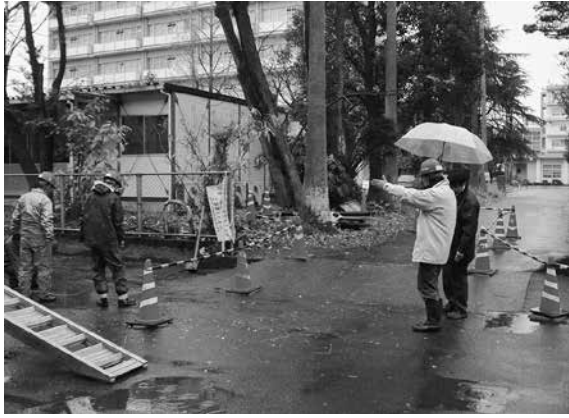
2016-H 漏水地点
