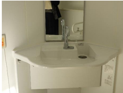
1階みんなのトイレ個室手洗い
