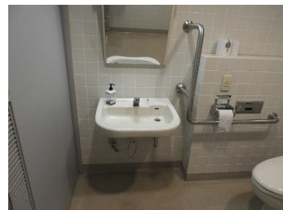
1,3,5階みんなのトイレ個室手洗い
