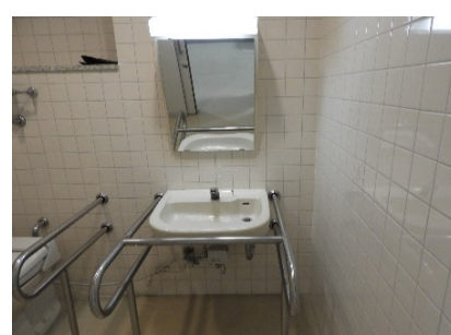
1階みんなのトイレ個室手洗い
