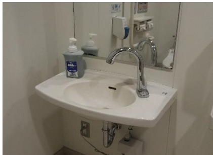
1階みんなのトイレ 個室内手洗い
