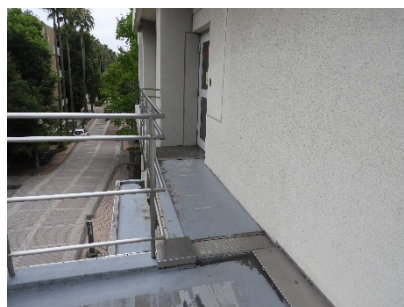
3階渡り廊下 (農学部研究棟D側) 段差 5cm
