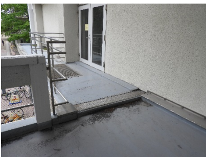
2階渡り廊下 (農学部研究棟D側) 段差 10cm
