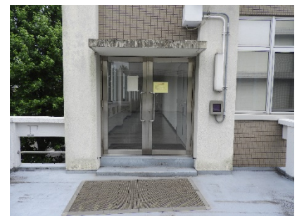
3階渡り廊下扉 (農・獣医共通棟側) 段差 30cm
