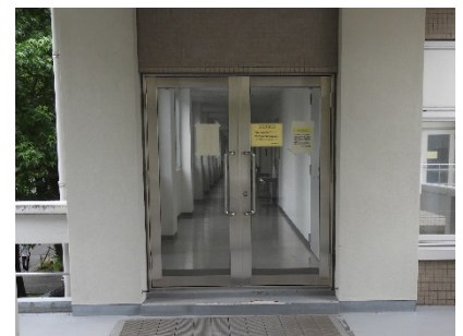
2階渡り廊下扉 (農・獣医共通棟側) 段差 20cm
