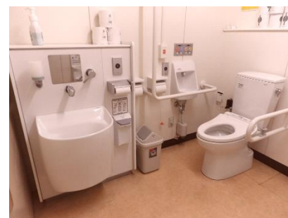
1階みんなのトイレ個室 オストメイト
