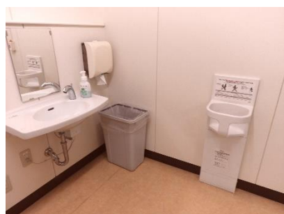
1階みんなのトイレ個室 手洗い・ベビーチェア
