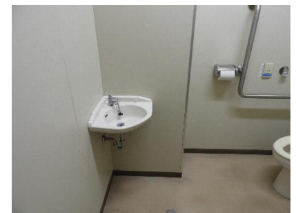
1階みんなのトイレ個室手洗い
