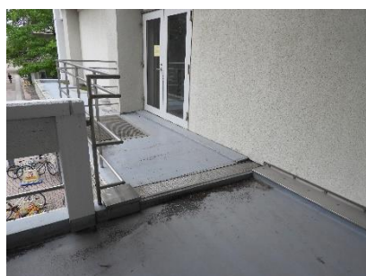
2階渡り廊下 (農学部研究棟 D 側) 段差 10cm
