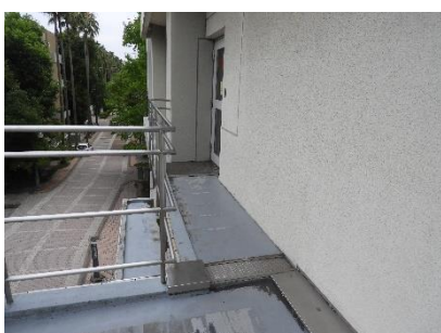
3階渡り廊下 (農学部研究棟 D 側) 段差 5 cm
