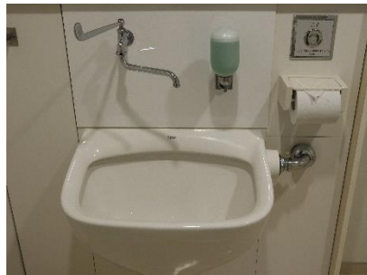
みんなのトイレ個室オストメイト
