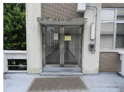
2.3階渡り廊下扉 (農・獣医共通棟側) 段差 20cm (2階) 23cm (3階)
