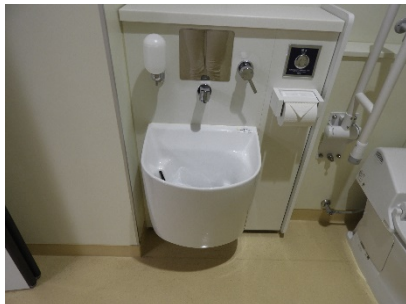
みんなのトイレ内 オストメイト
