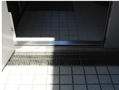
正面玄関扉下段差
