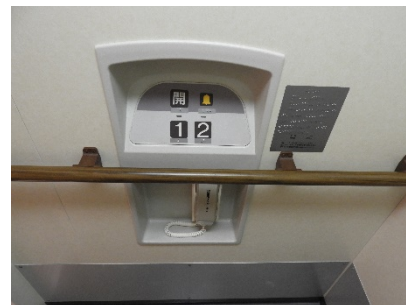
エレベーター内操作ボタン
