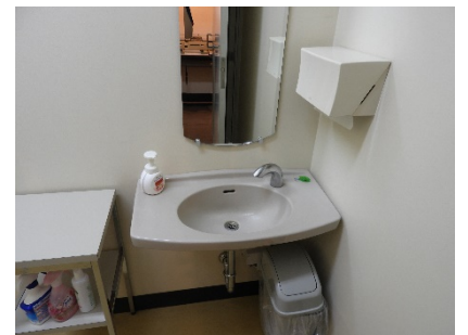
1階みんなのトイレ個室手洗い
