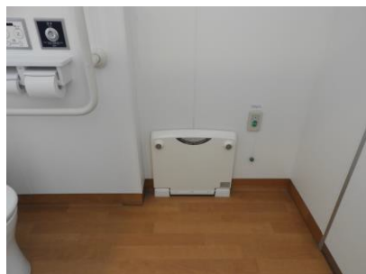
2階女子多目的トイレ内 フィッティングボード
