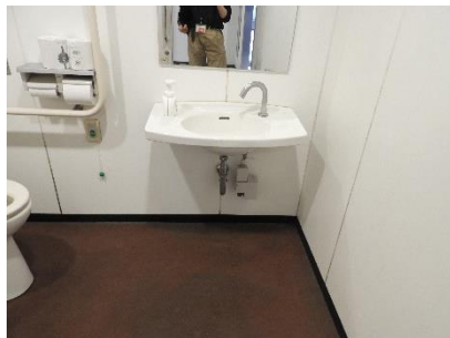
1階みんなのトイレ個室手洗い
