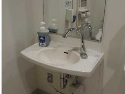
1階みんなのトイレ個室手洗い
