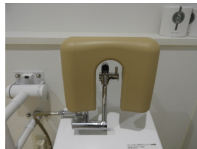
3階みんなのトイレ個室オストメイト
