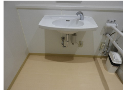
3階みんなのトイレ個室手洗い
