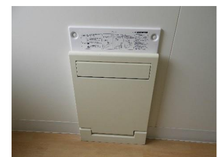
3階女子福祉型トイレフィッティングボード
