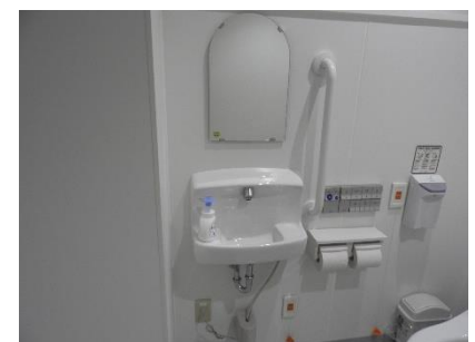
1階みんなのトイレ個室手洗い
