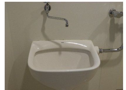
1階みんなのトイレ 個室オストメイト
