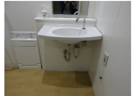
1階女子福祉型トイレ個室内手洗い
